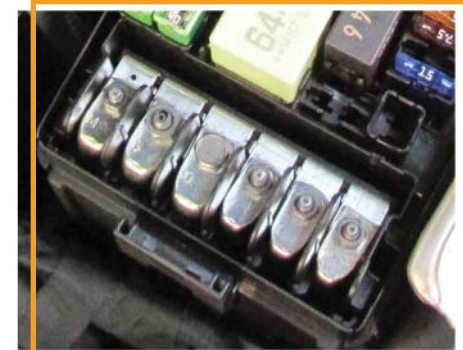
SA Electrical Distribution Panel
